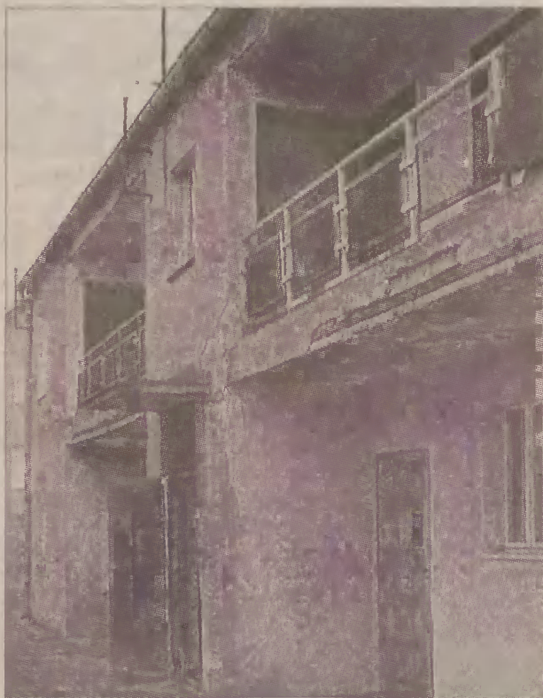
Budynek przy ulicy Żeromskiego wymaga kapitalnego remontu.
