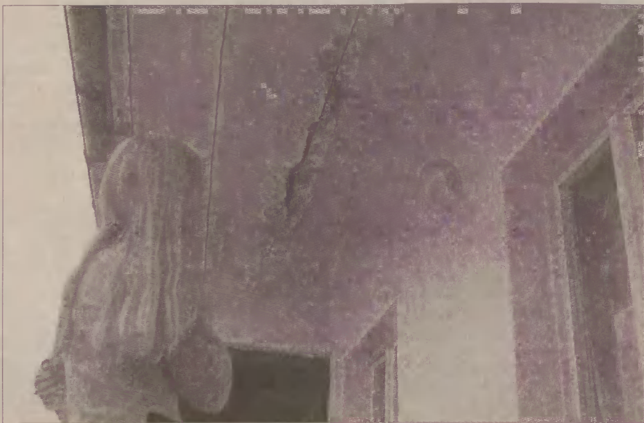
W fatalnym stanie znajdują się balkony w tym bloku.
