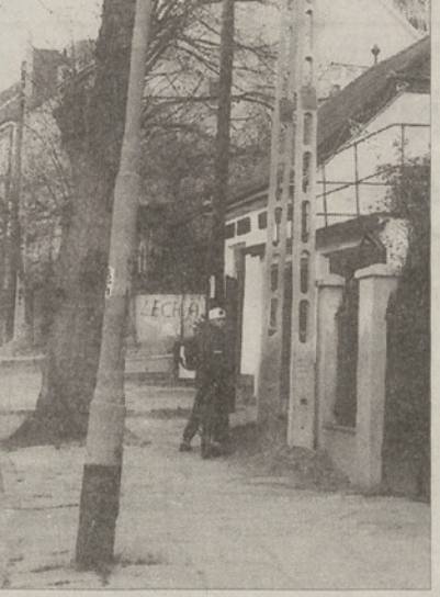
Miastu - jak widać - nie przeszkadza pomiędzy elektrycznymi czy modernistycznymi willami żelbetonowe słupy i „pajęczyna” drutów, zrywana przy każdym podmuchu wiatru przez łamiące się galeje. Fot. Maria Giedz
