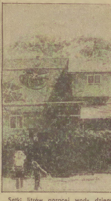
Setki litrów gorącej wody dziennie podgrzewanych jest energią słoneczną dzięki urządzeniu zainstalowanemu na dachu tego domu w Kalifornii (USA). Woda przepływająca przez 100-metrowej długości rurę plastikowego węzła ogrzewa się podczas operacji słonca.
