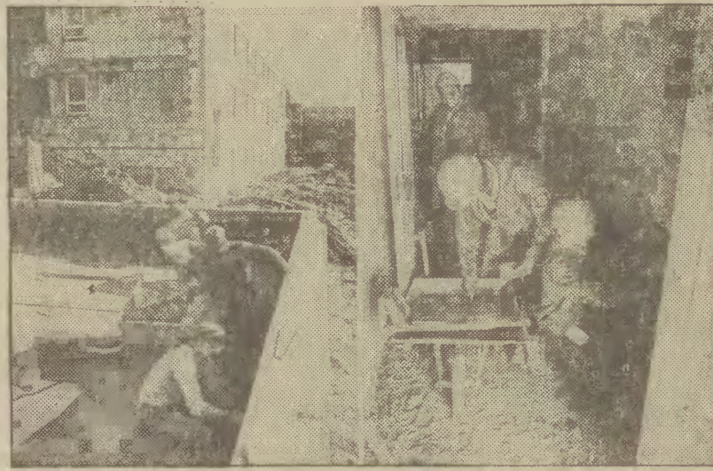
Na zdjęciu: z lewej trzysobowa brygada lastrykarzy pod kierunkiem majstra Mieczysława Jureka, z prawej — konstruktor Waldemar Krutz opiekuje się chłopcami z Zasadniczej Szkoły Budowlanej.
