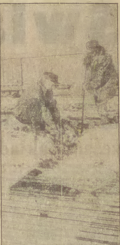
Mrażna zima to trudny okres na kolei. Na stacji Warszawa Główna Towarowa zamierzają wykonać prace remontowe.
