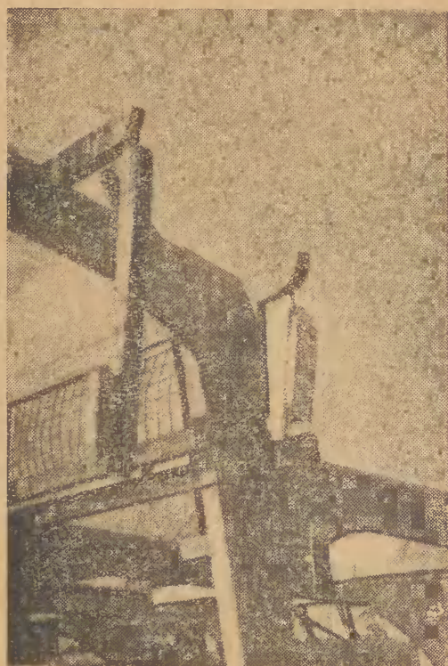
Belki podłużne koło dylatacji strącone podmuchem.
