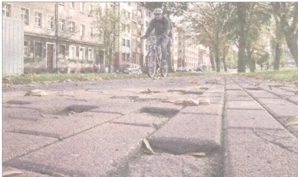
Polbrukowa i pełna dziur ścieżka przy ul. Kołłątaja to jedna z najgorszych w mieście dróg rowerowych. Zastąpi ją czerwona nawierzchnia bitumiczna.
