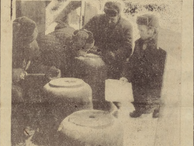
Na wieży ratusza głównomiejskiego pracują przy instalowaniu dzwonów: brygadziści Eugeniusz Arendt z Janem Czerniakiem, Antonim Arendtem i Zdzisławem Sygitem — wszyscy z Pracowni Konserwacji Zabytków. Fot. Wł. Nieżywiński
