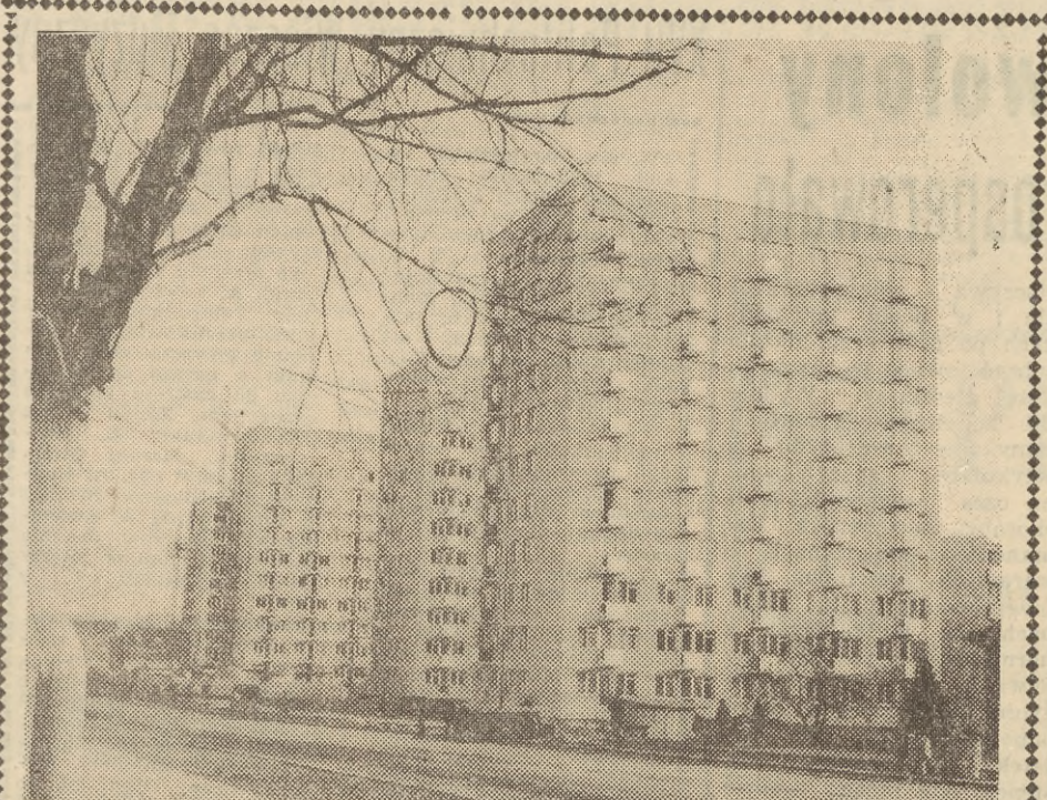
Nowe osiedle mieszkaniowe w Elblągu przy ul. Nowowiejskiej w trakcie budowy. Fot. Wł. Nieżywiński
