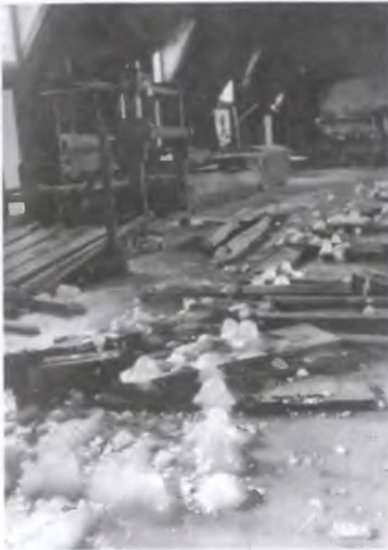
Magazyn zbiorów muzealnych, stan sprzed remontu dachu Domu Zakonnego - fot. archiwum muzeum.
