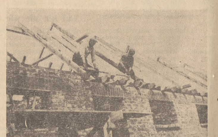
Choć w polu pracy wiele, spółdzielcy znajdują czas na budowę chlewni. Pomiędzy ona 200 świń i przyczyni się do podniesienia hodowli
